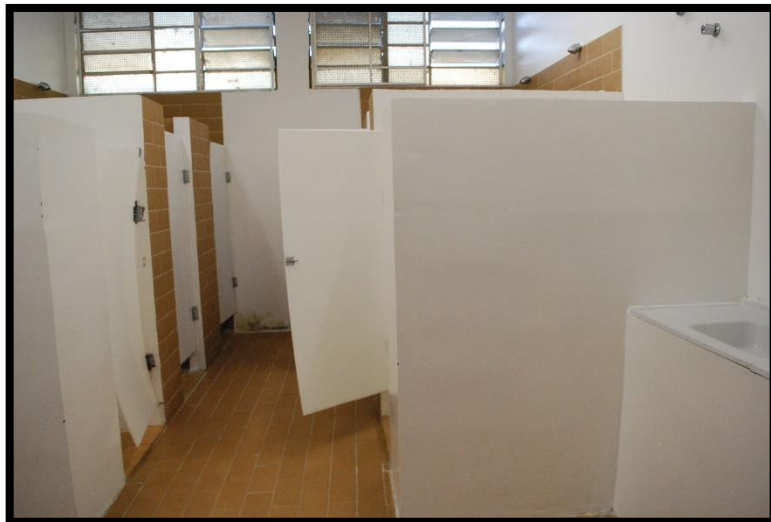
Banheiro do alojamento das meninas. Fonte: MNPCT, 2023.
