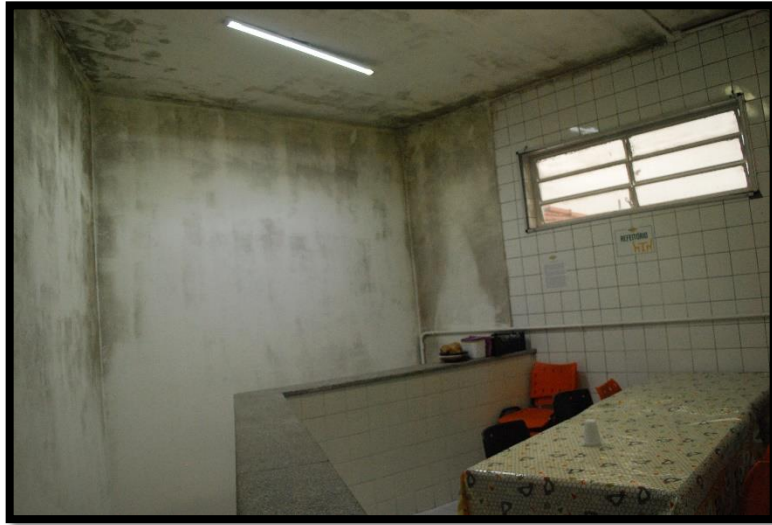
Cozinha com paredes mofadas. Fonte: MNPCT, 2023.
