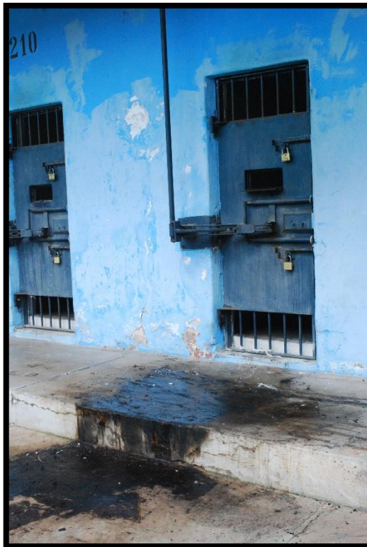
Porta automática das celas. Fonte: MNPCT, 2023.
