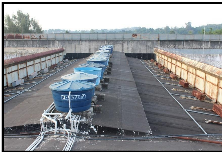
Caixas d'água abertas e com sujeira. Fonte: MNPCT, 2023.
