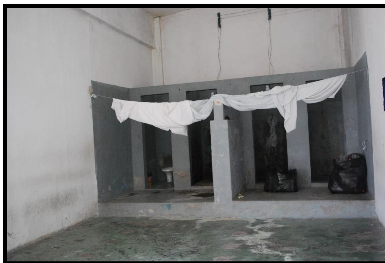
Cortinas de banheiro improvisadas no espaço onde ficam as mulheres que não têm visitas. Fonte: MNPCT, 2023.
