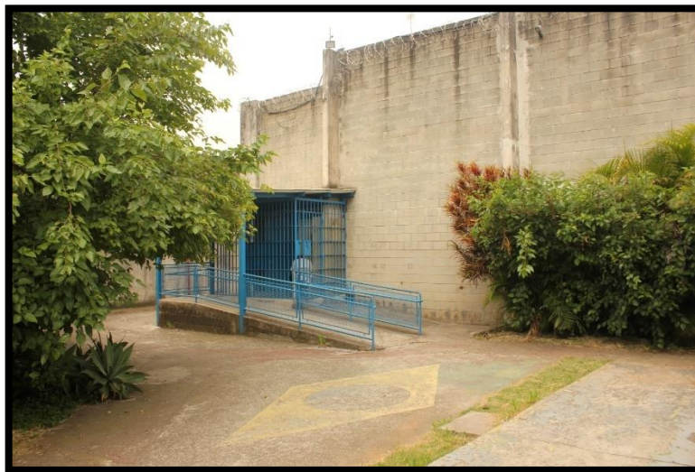
Gaiola de controle de acesso à parte interna da unidade. Fonte: MNPCT, 2023.
