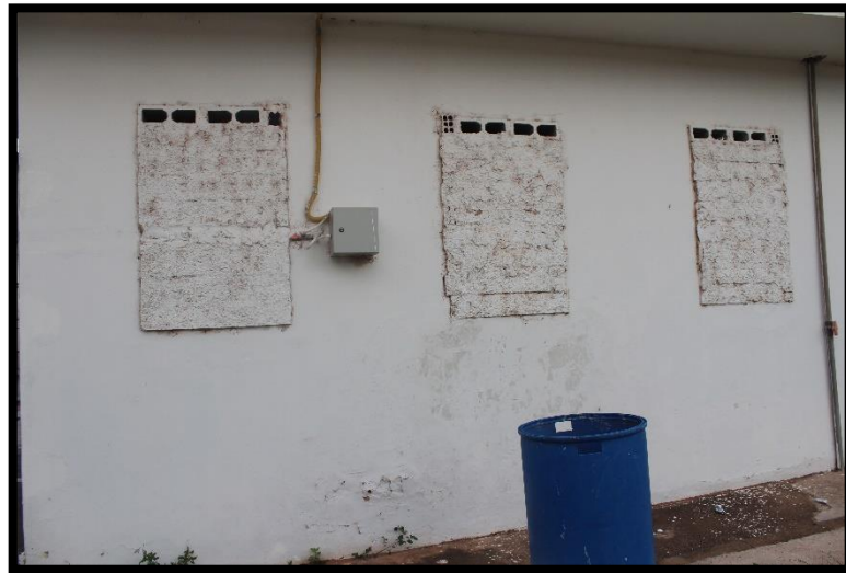
Visão externa do fundo das celas da inclusão, com as ventanas tampadas. Fonte: MNPCT, 2023.
